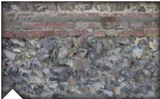
Le silex, présent dans le sol local entre les couches de craie, est utilisé pour un appareillage de maçonnerie mixte associé avec la brique.
