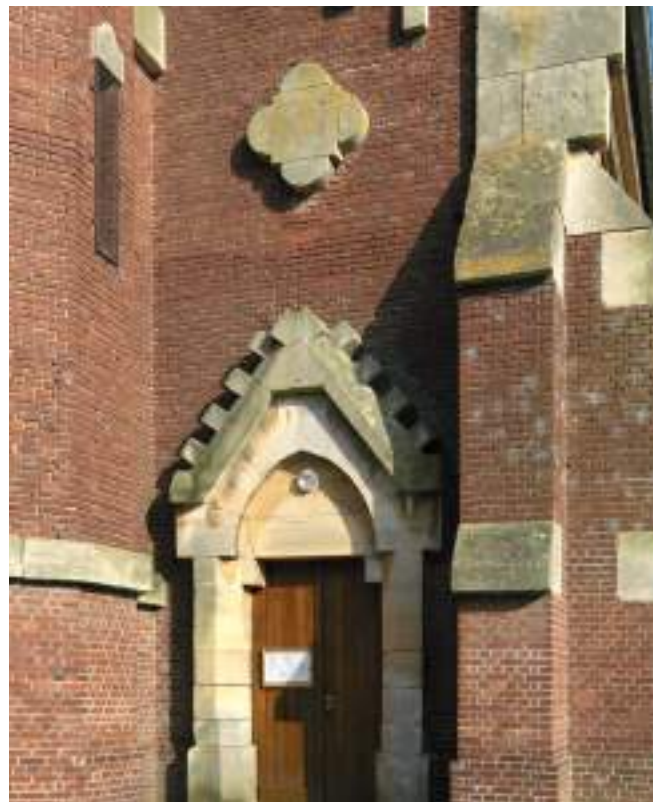
Pierres d'attente sur la façade principale.
